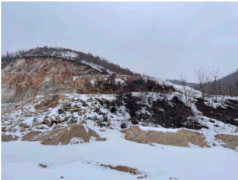
照片 3-1 崩塌地质灾害隐患点
