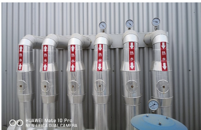
图 4-65 厌氧反应罐外供热系统
