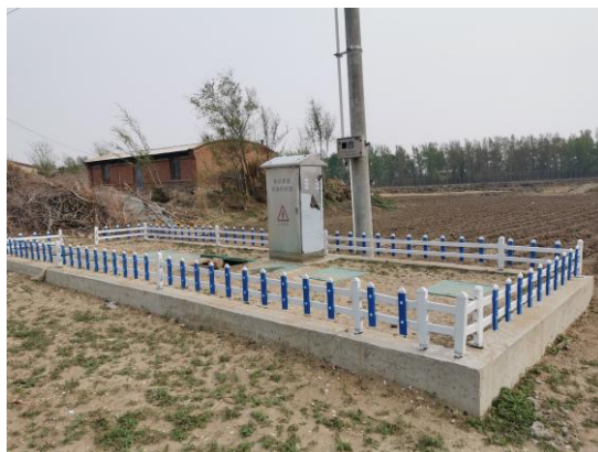
图 3-4 西佛镇一体化设备现状
