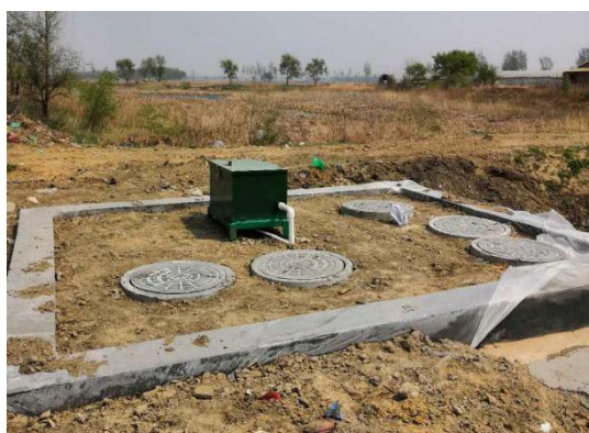
图 3-6 新台镇污水处理设施
