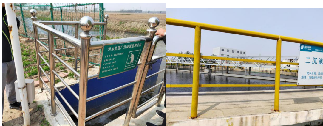
图 3-1 台安县污水处理厂运行情况
