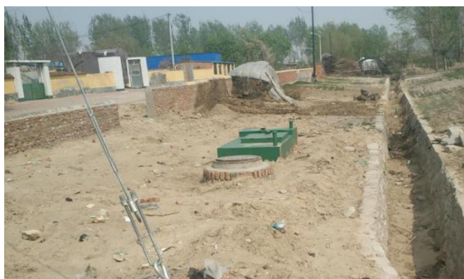
图 3-8 洪家农牧场洪家村在建污水处理设施
