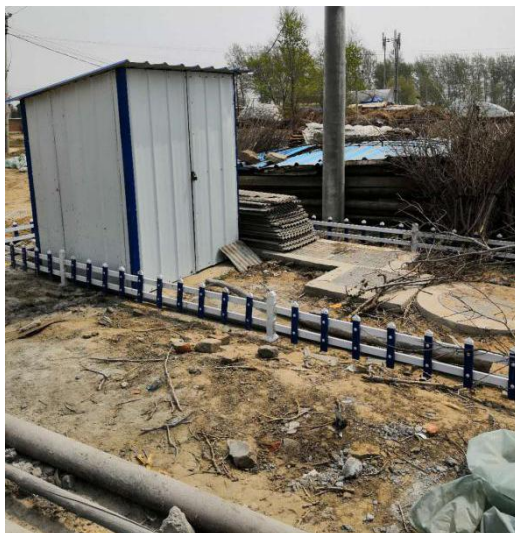
图 3-5 富家镇污水处理设施
