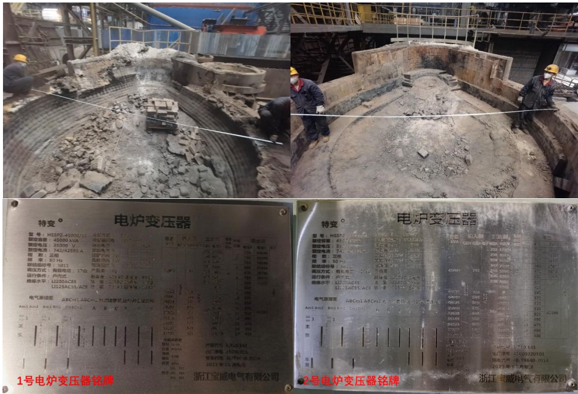
图 3.1-5 电弧炉炉壳直径测量与配套变压器铭牌 表 3.1-9 GB 50439 中炉容与直径、变压器容量的匹配关系
