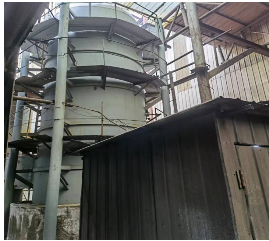
钠碱法脱硫除尘装置
