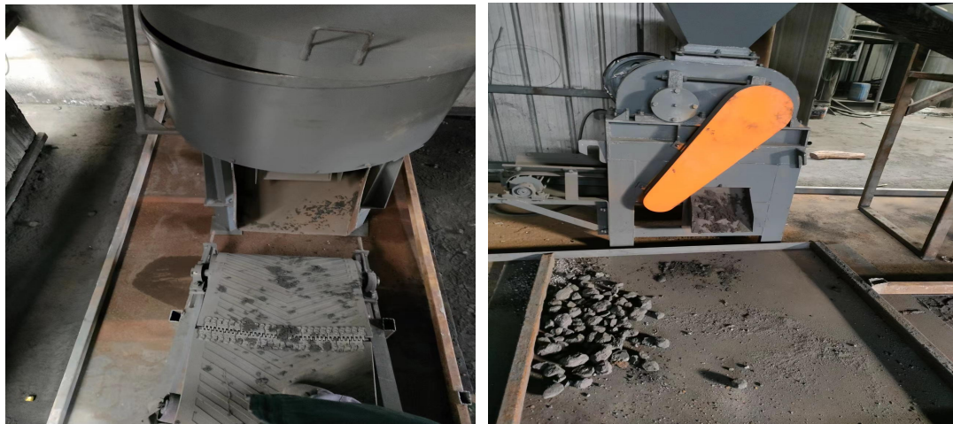
煤焦油煤粉等回用时的混料压球设备、晾球区
