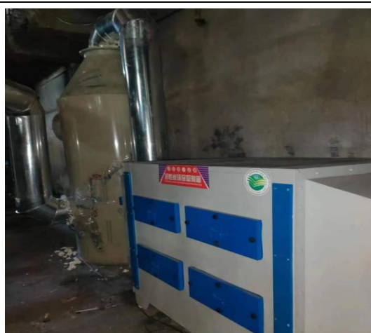
水喷淋+活性炭处理装置
