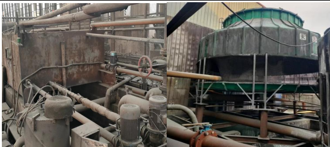
图 5.1-2 油循环废水处理设施及冷却塔
