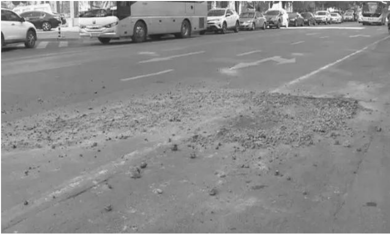
图 13-1 城市沥青道路损坏
