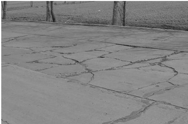
图 14-1 混凝土路面损坏
