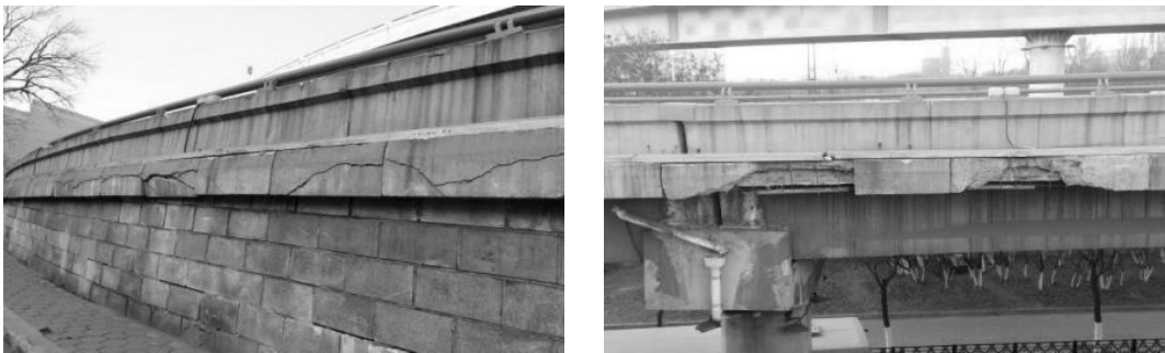
图 16-1 城市桥梁破损
