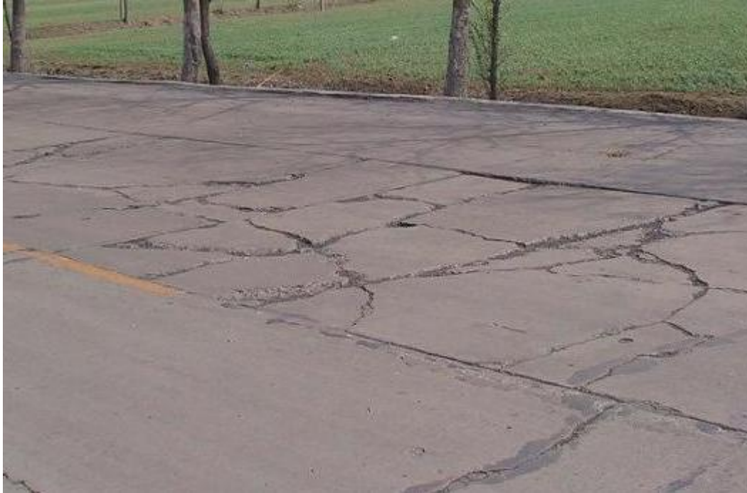
图 14-1 混凝土路面损坏
