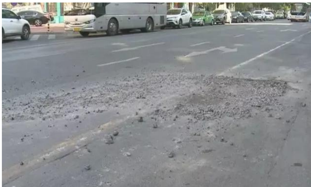
图 13-1 城市沥青道路损坏
