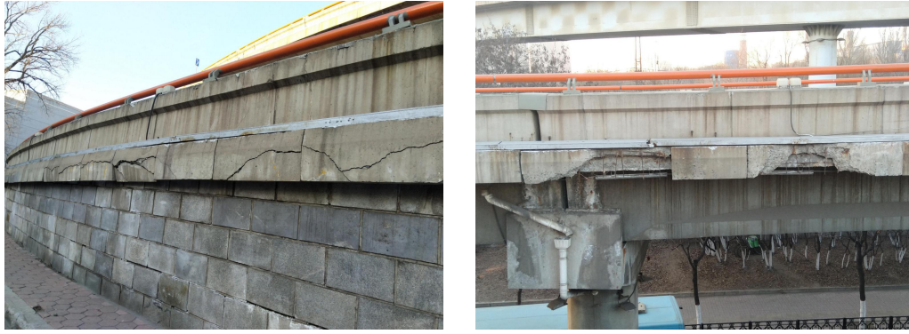
图 16-1 城市桥梁破损
